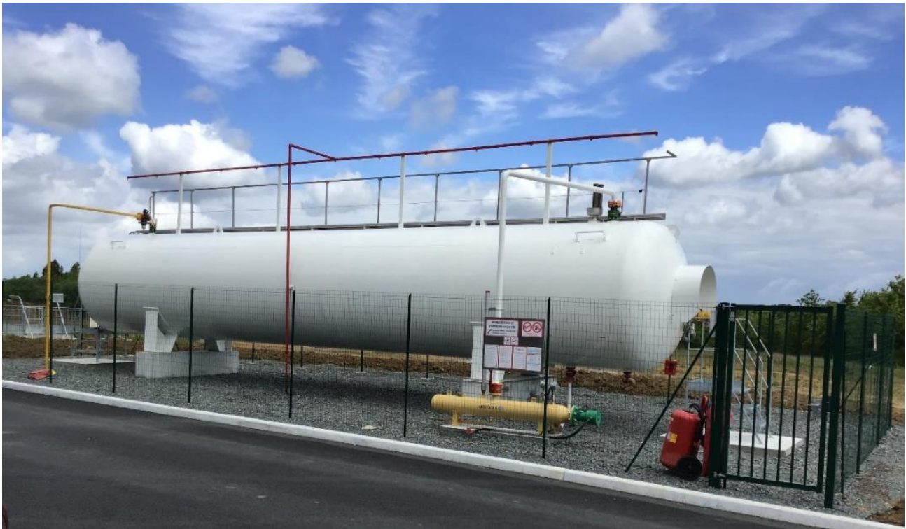
Photo 1 : Exemple de stockage de propane
